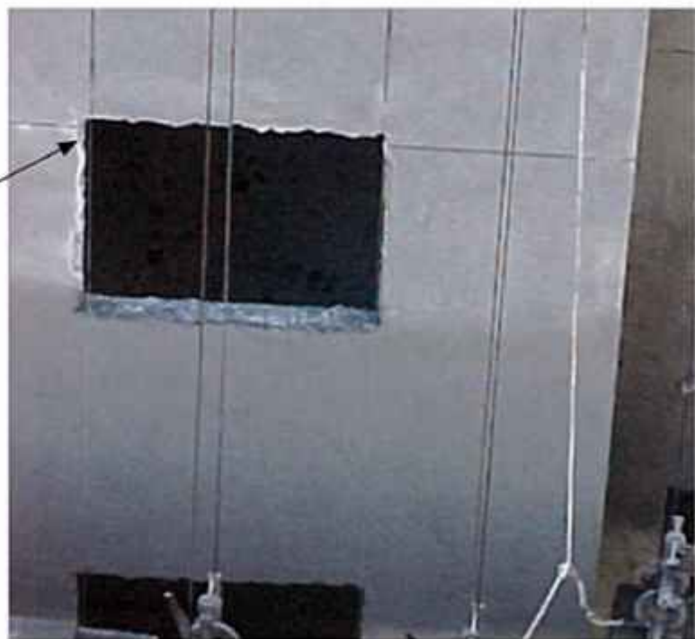
FIGURA 8.6 Posicionamento inadequado da junta — grande afastamento da região de encontro da alvenaria com a estrutura.
