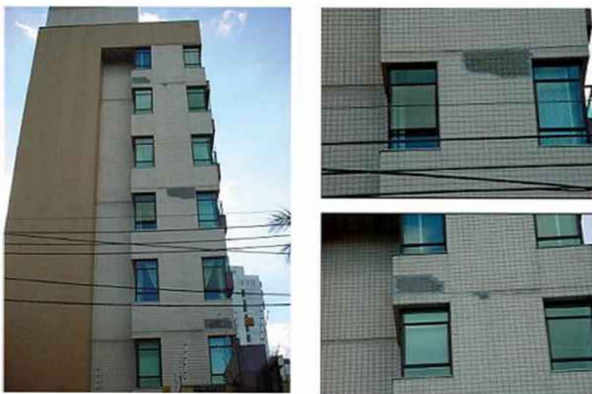
FIGURA 1.4 Edifício residencial. Fachada com destacamento com início na região da junta de movimentação.
