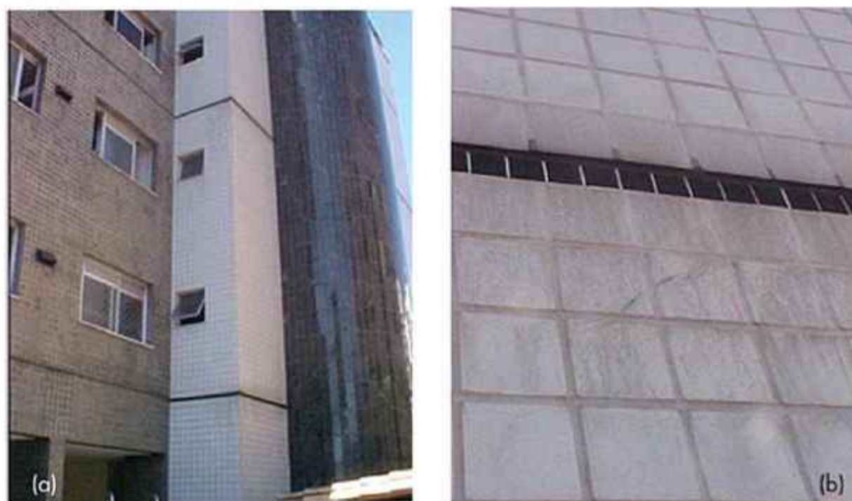
FIGURA 1.3 (a) Edifício residencial. Fachada comprometida por manchamento do selante; (b) Detalhe do manchamento do revestimento e deterioração do selante.
