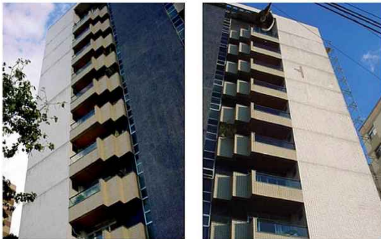
FIGURA 1.2 Edifício residencial. Fachadas comprometidas por manchamento do selante.
