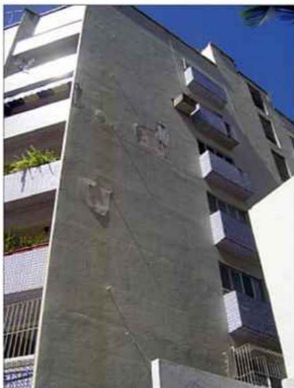
FIGURA 1.1 Fachada de edifício deteriorada.
