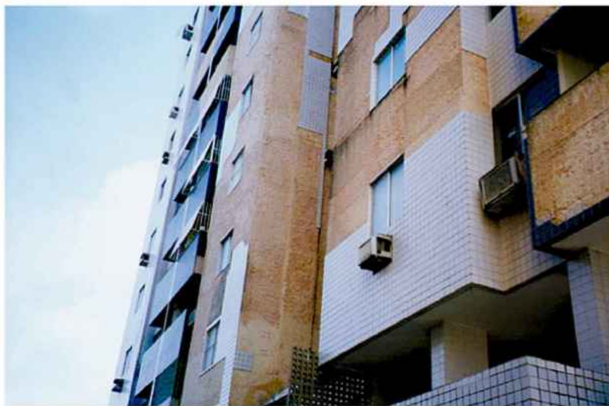
FIGURA 2.3 Ilustração de queda das placas cerâmicas e da camada de fixação da fachada de edifício por falha na interface da camada de fixação-superfície do emboço (Foto: ANGELO JUSTI).
