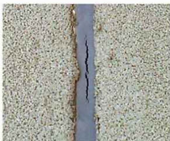
FIGURA 6.2 Vista frontal de uma junta que apresenta ruptura coesiva.
