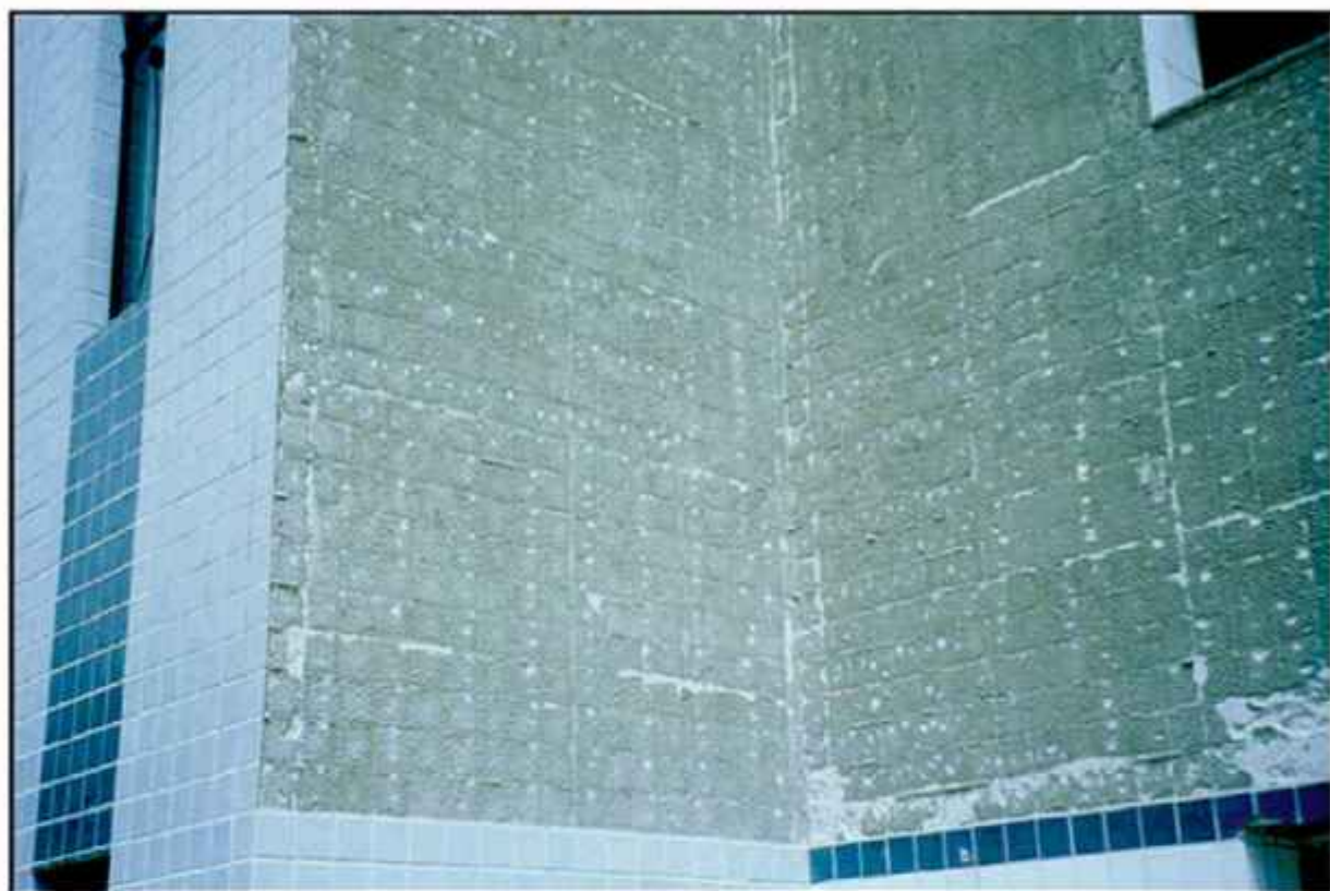
FIGURA 2.4 Ilustração de queda das placas cerâmicas de fachada de edifício em que a camada de fixação aderiu à superfície do emboço (Foto: ANGELO JUST).
