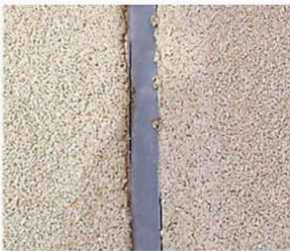
FIGURA 6.1 Ruptura adesiva: perda de adesão do selante.
